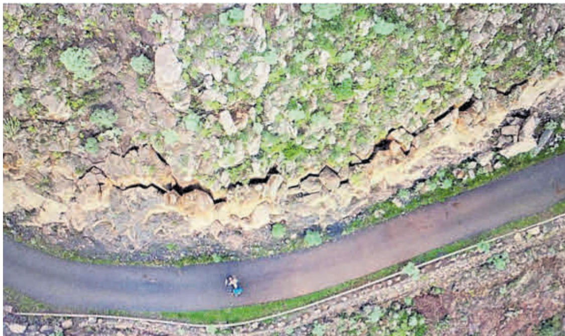
Grieta en el talud de acceso a Enchereda. | E.D.
