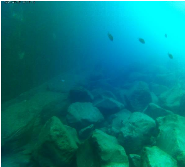
Hormigón en socavación y escollera de protección
